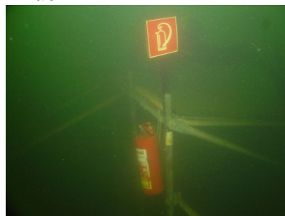
Brandschutz – auch in 11m Tiefe
